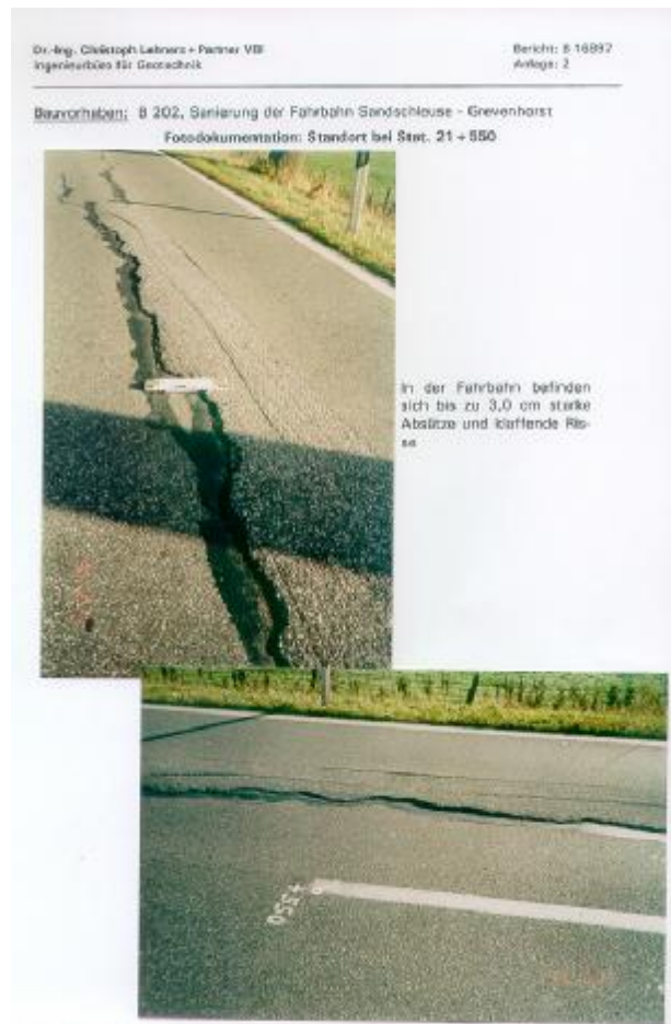
Bild 4: Rissbildung auf der Fahrbahn
